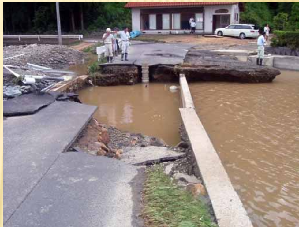
（破壊され流失した市道朝山54号線）
