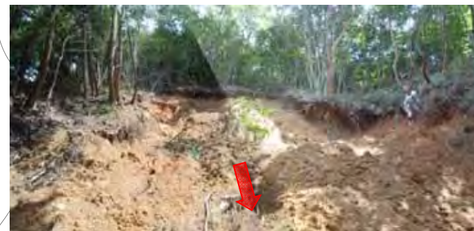
崩壊した斜面の様子
