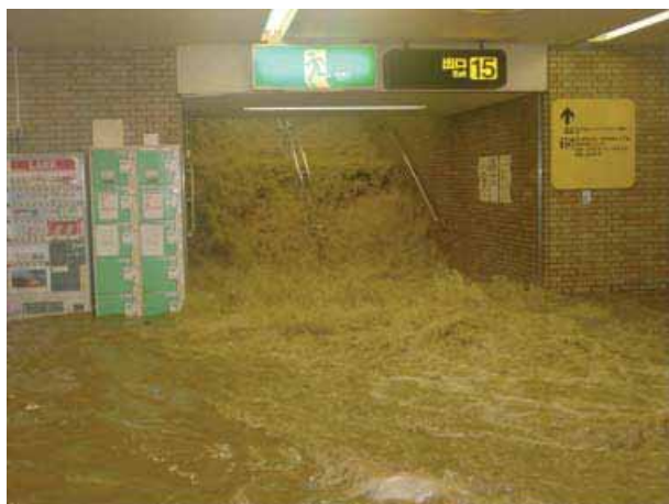
▲福岡水害により浸水した福岡市営地下鉄博多駅
