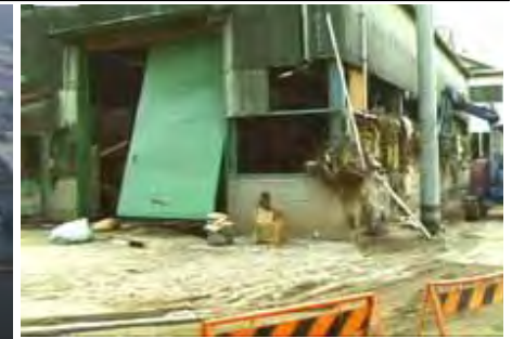
洪水流で破壊された工場 (平成12年9月東海豪雨(名古屋市西区)) (出典:国土地理院HP 東海豪雨災害緊急調査報告)
