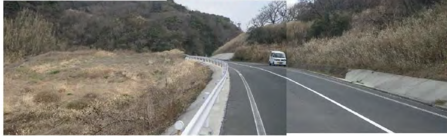
■亀裂発生直後の県道の様子 (2月10日撮影)
