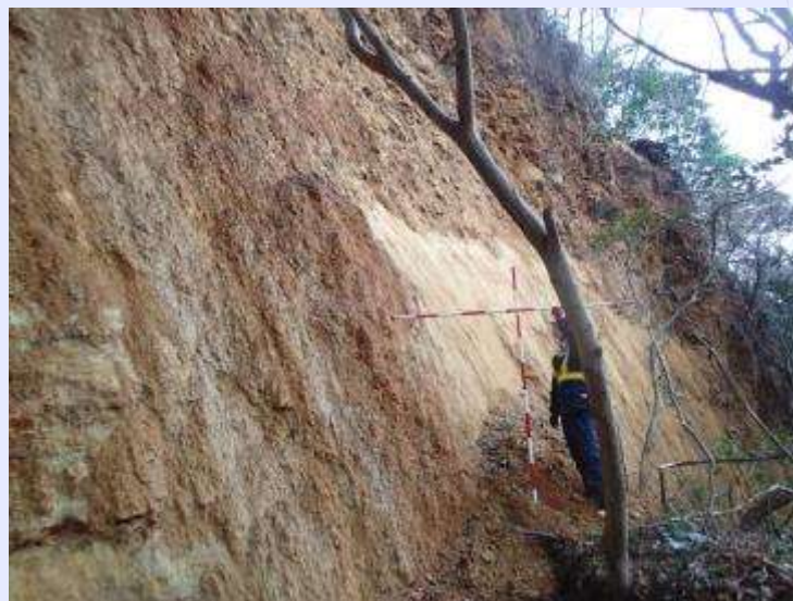
② 滑落面の露頭 条痕あり
