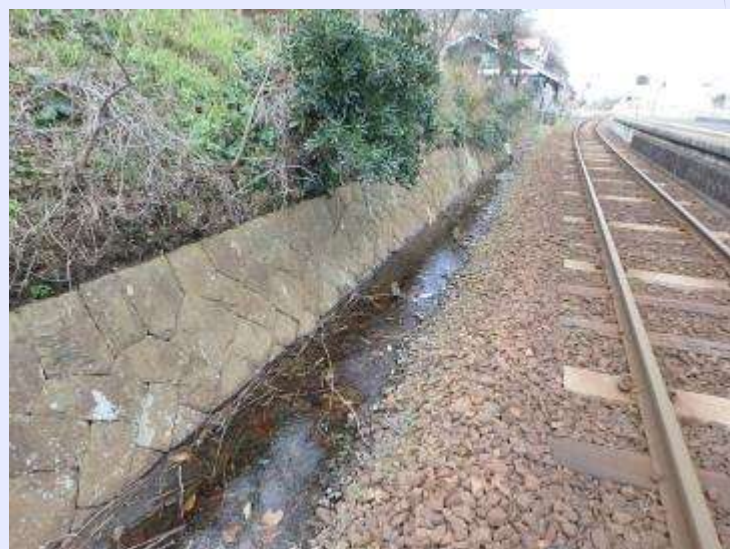
⑨ 斜面下部 線路脇の湧水
