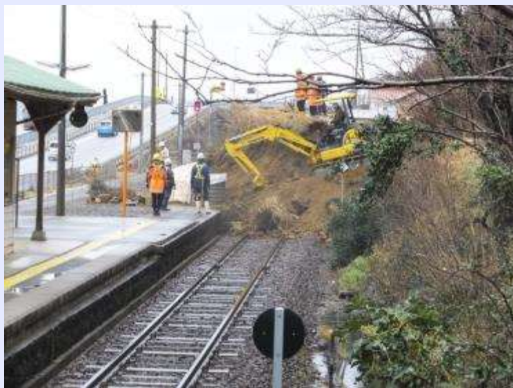
⑥ 軌道敷への土砂流入
