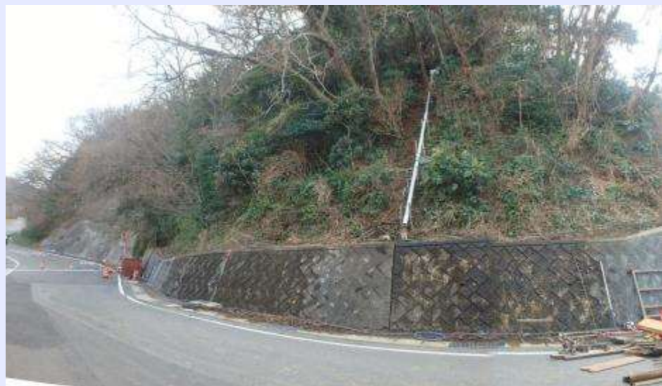
⑧ 周辺斜面 市道沿いの湧水
