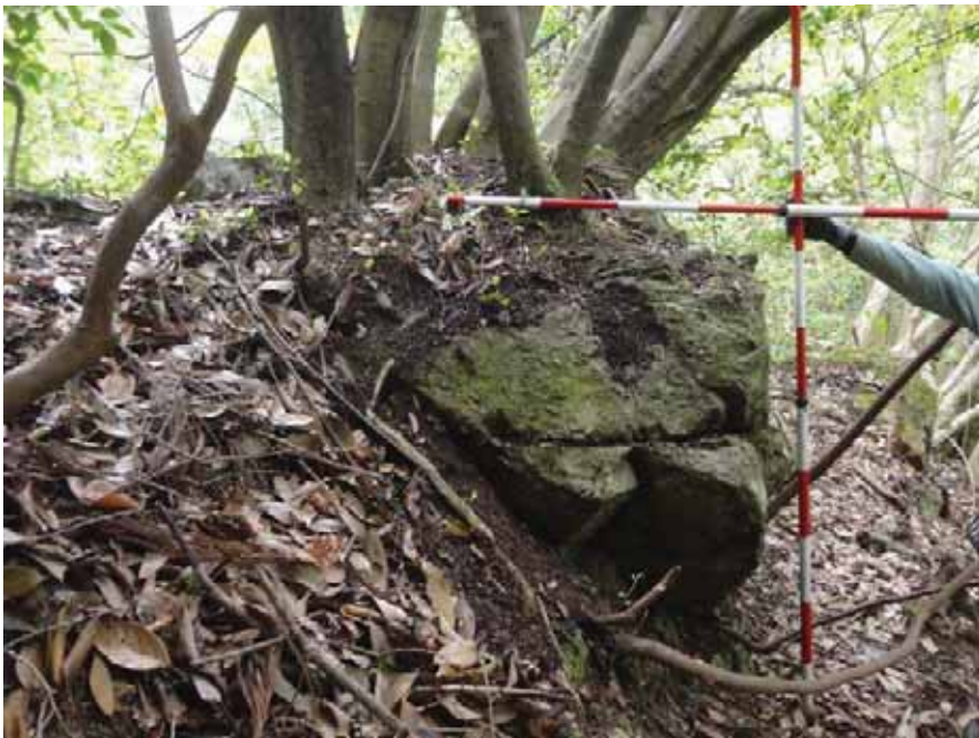
落石斜面と近接する斜面上にある浮石(右は樹根の成長により不安定化する)
