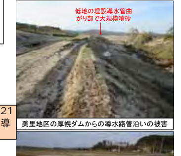
美里地区の厚幌ダムからの導水路管沿いの被害
