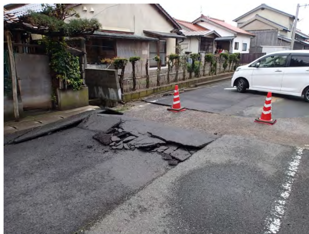
図8. 暗渠のすぐ北側で, アスファルトがモールトラック状に座屈変形している.
