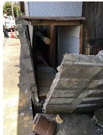
図9. 図8の地点の近傍におけるブロック塀の倒壊
