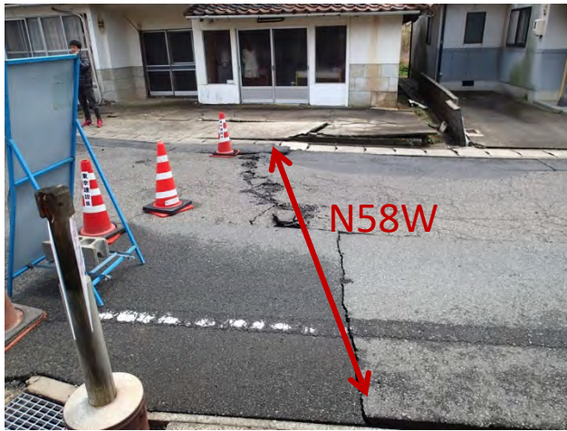
図6. 路面の開口亀裂および家屋基礎の損壊. 右側が沈降している.
