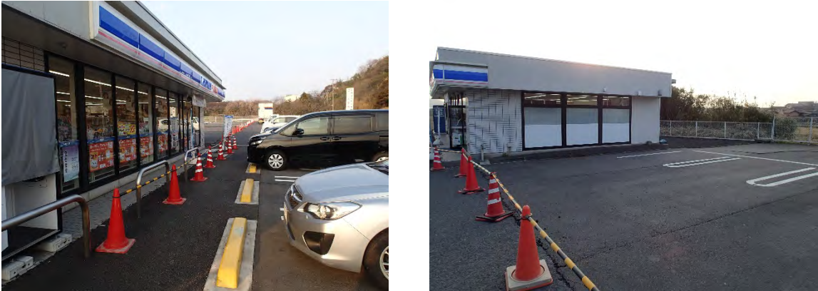
図15. 大田市波根町のコンビニエンスストア駐車場の波状変形
