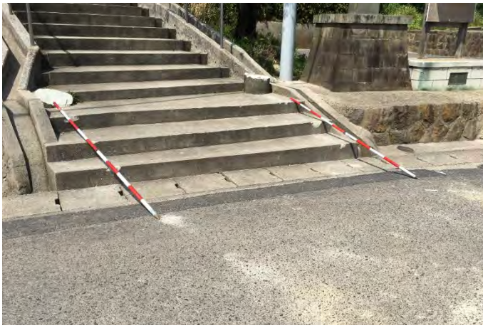
図3. 苜田神社の石鳥居の倒壊 (12:04時点で撤去済)
