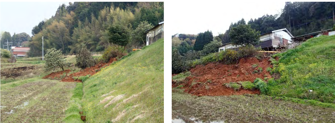
図16. 大田市朝山町の地盤崩壊状況。作業場の基礎の一部も崩落している。
